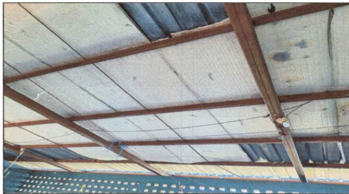
Foto 3: Láminas en mal estado debido al deterioro y paso del tiempo
