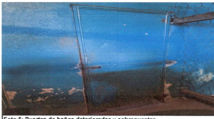
Foto 5: Puertas de baños deterioradas y sobrepuestas
