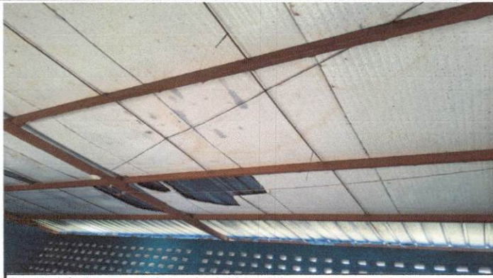
Foto 1: Láminas en mal estado debido al deterioro y paso del tiempo
