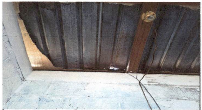
Foto 4: Láminas en mal estado debido al deterioro y paso del tiempo
