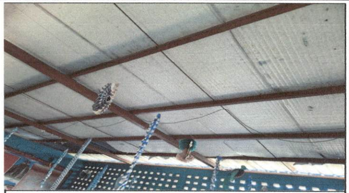
Foto 2: Láminas en mal estado debido al deterioro y paso del tiempo
